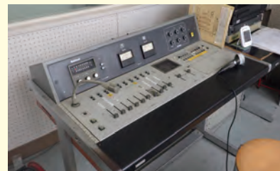
学校管理運営事業 学校施設修繕費 北谷小学校放送設備
